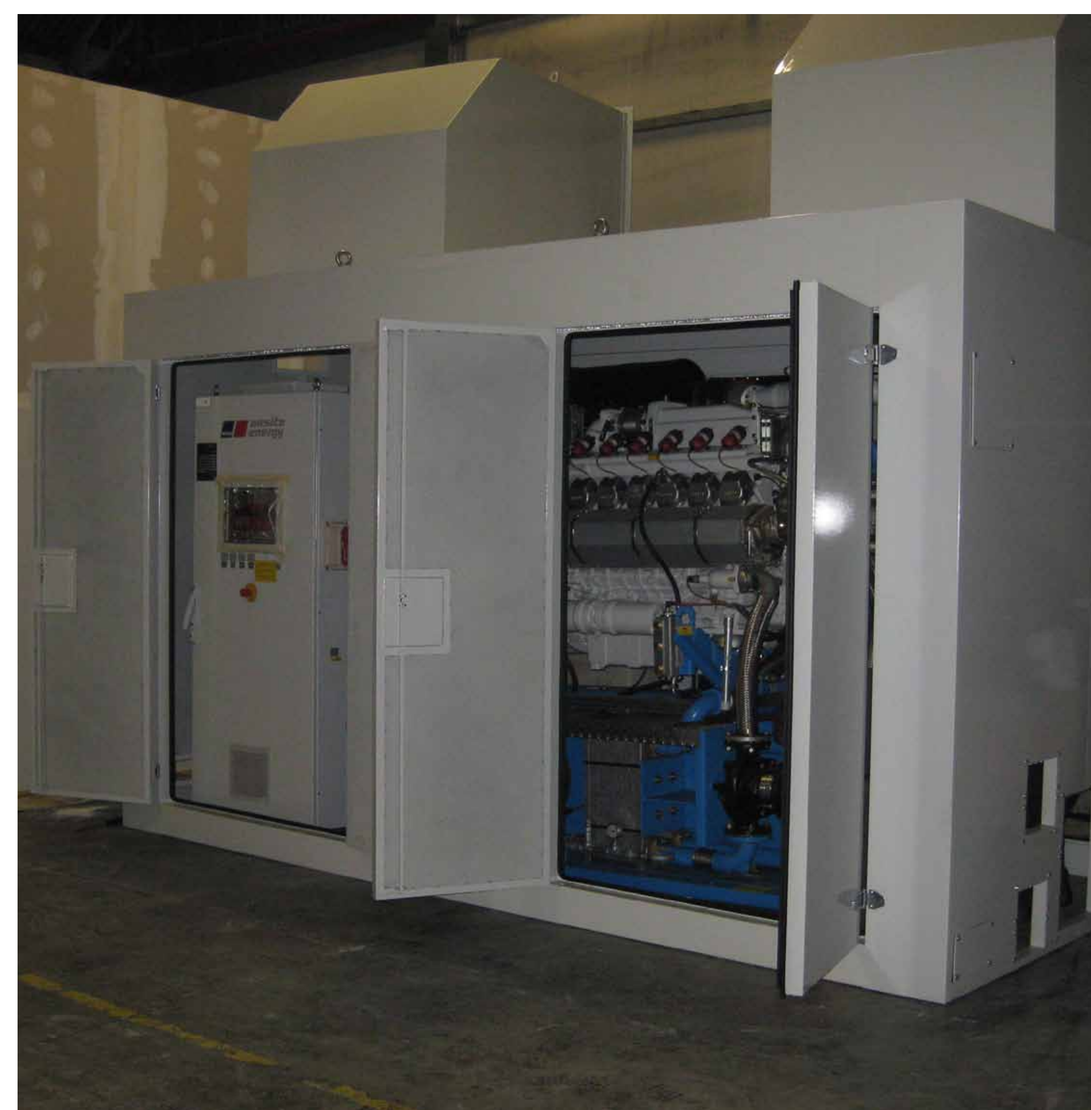
Cogeneratore con cabina
